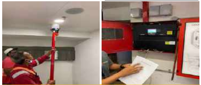
Kerja Penyelenggaraan Sistem Fire Fighting
