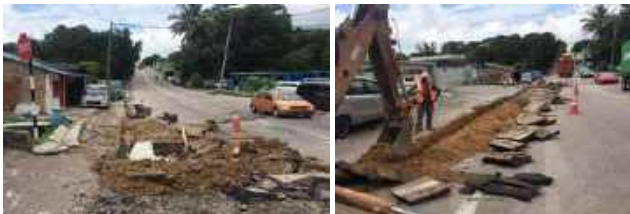
Gambar 5.1 : Kerja Penanaman Kabel Optik Tiada Kelulusan Korekan Terbuka Di Jalan Tahana, Larkin.
