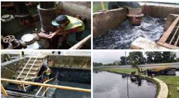
Gambar 3.36: Kerja Kerja Penyelenggaraan Loji Rawatan Kumbahan MBBJ.
