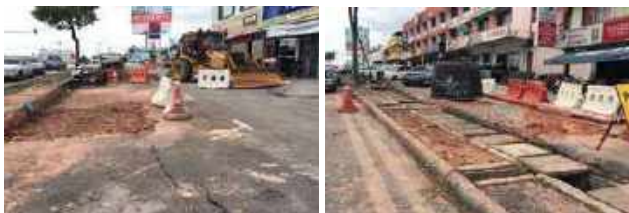
Gambar 5.4 : Kerja HDD paip PN10, Tidak mengikut syarat permit, Di Jalan Susur Jalan Tebrau, Taman Kebun Teh.
