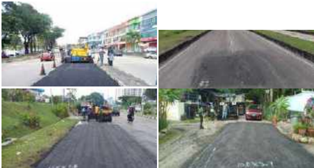
Gambar 3.1: Kerja-Kerja Penyelenggaraan Jalan. (Kerosakan Jalan).
