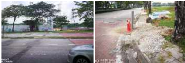
Gambar 5.3 : Kerja-Kerja Penanaman Paip Air Tidak Mengikut Syarat Permit, Di Jalan Dato' Onn Utama, Bandar Dato' Onn.
