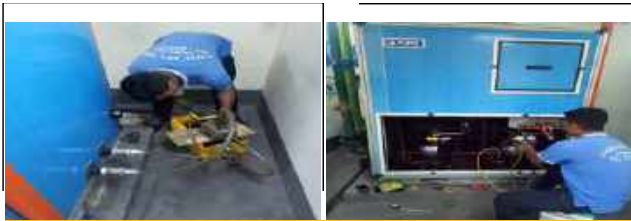
Kerja-Kerja Penyelenggaraan Sistem Hawa Dingin Central Unit
