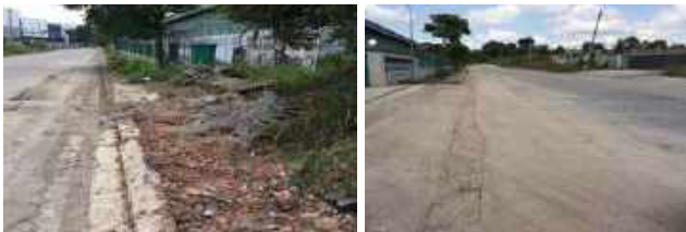
Gambar 5.2 : Kerja Penanaman Kabel Optik Yang Tidak Mengikut Syarat-Syarat Am Permit, Di Jalan Riang 21, Kaw, Perindustrian Tampoi.
